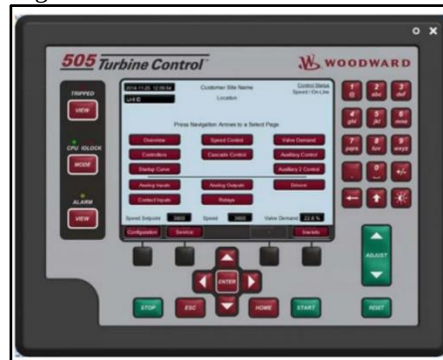
Figura 7. Controlador Woodward 505XT
