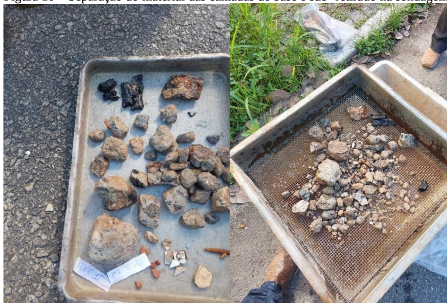
Figura 10 – Separação do material das camadas de base e sub- retirado na sondagem.
