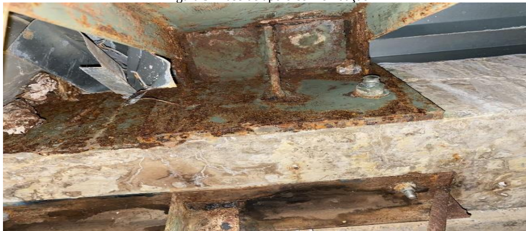
Figura 3- Base de apoio com oxidação
