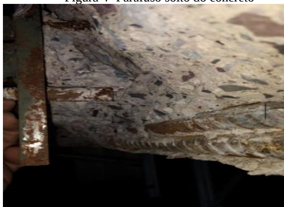
Figura 4- Parafuso solto do concreto
