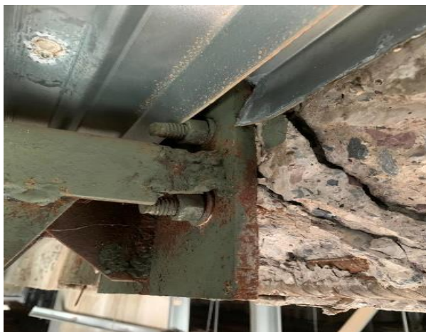
Figura 6- Deslocamento do concreto
