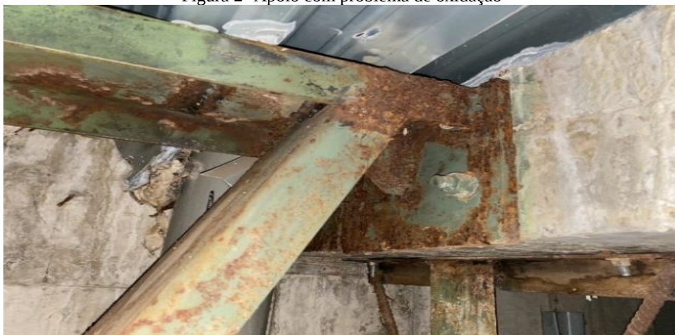
Figura 2- Apoio com problema de oxidação
