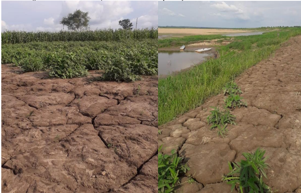
Figura 9: Características superficiais do solo com presença de rachaduras da área de estudo.
